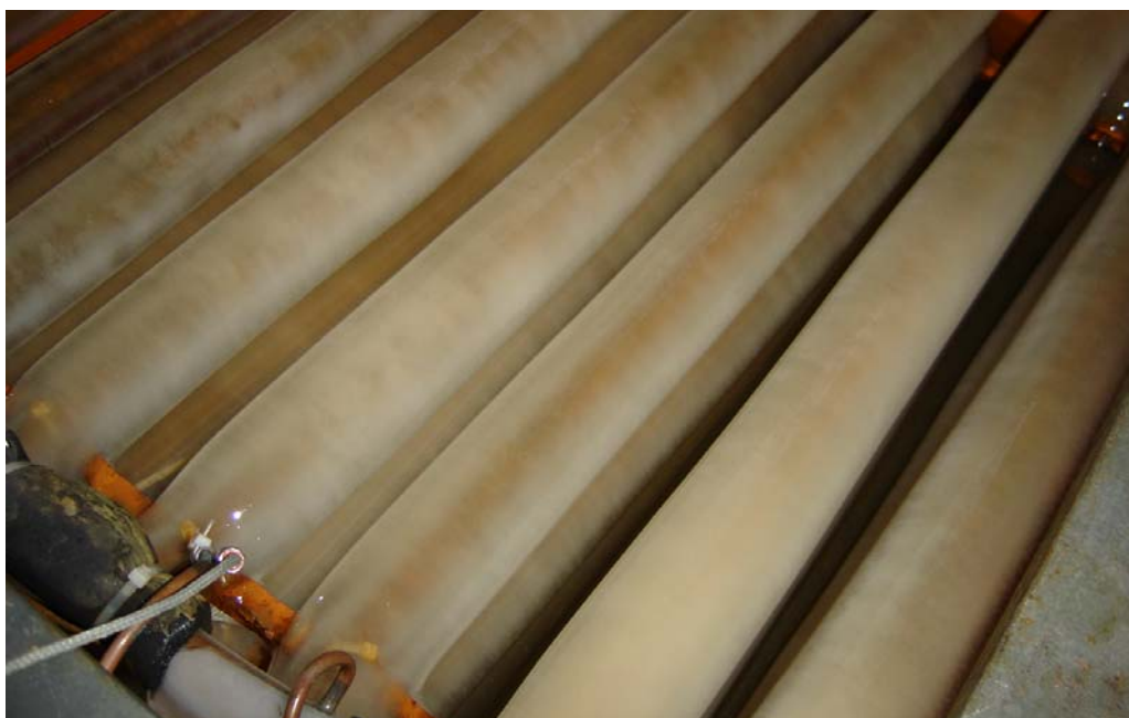
Figura 39. Cilindros de gelo formados em torno da serpentina do evaporador da bomba de calor “B1” após um ensaio nas condições nominais de operação.
