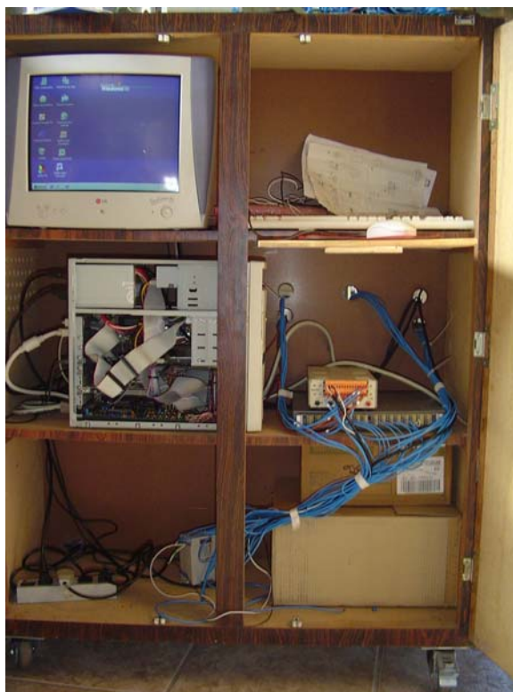
Figura 27. Sistema de aquisição de dados montado em armário.
