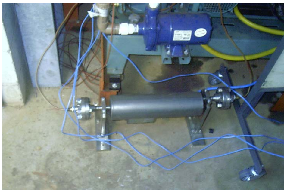
Figura 25. Sensor tipo Coriolis utilizado para medição de vazão de fluido refrigerante das bombas de calor.
