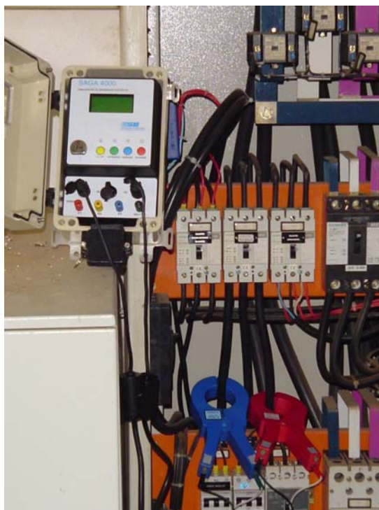
Figura 37. Medidor/analizador de energia elétrica instalado na Granja Leiteira.
