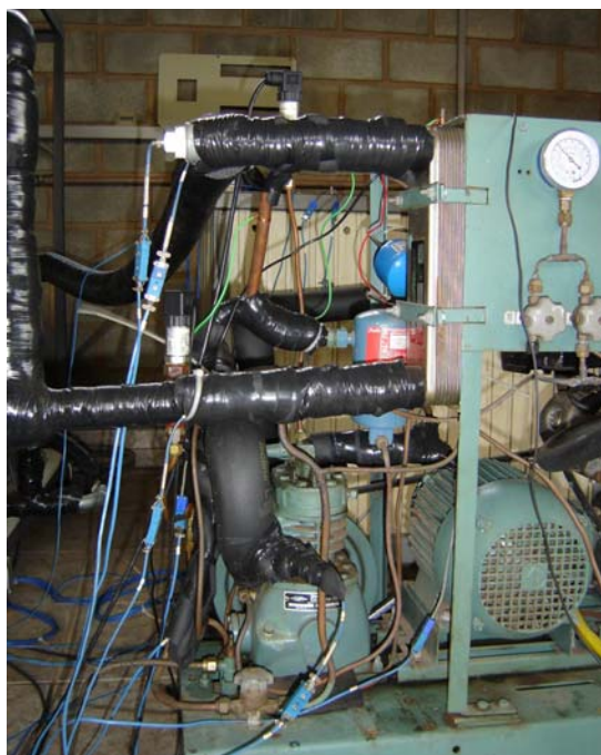
Figura 29. Transmissores de pressão e termopares instalados na bomba de calor “B1”.
