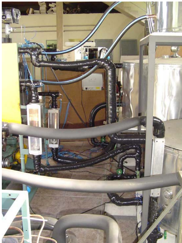
Figura 20. Reservatórios térmicos conectados aos trocadores de calor das bombas de calor.
