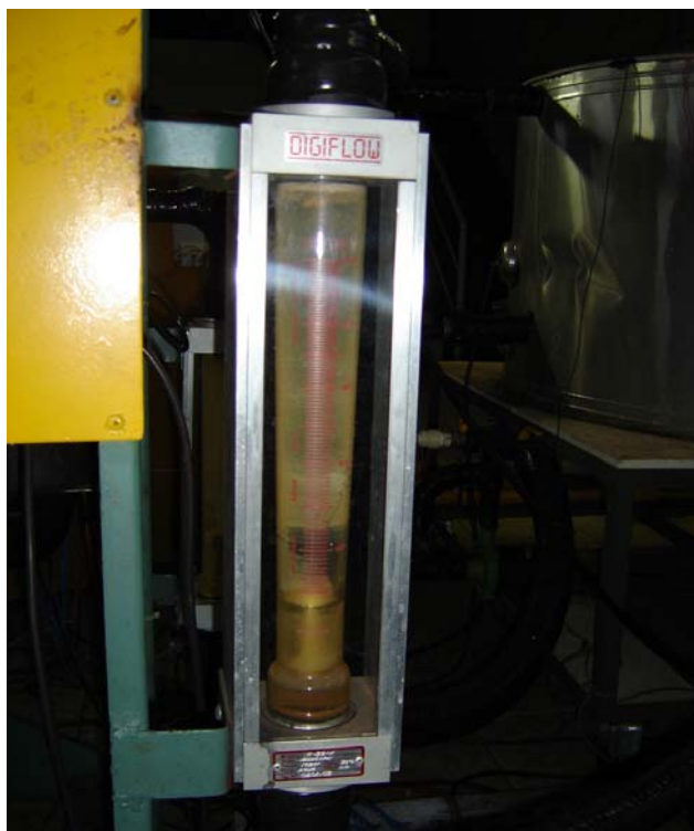
Figura 26. Rotâmetro utilizado para controle e medição de fluxo de água e solução nos trocadores de calor das bombas de calor.
