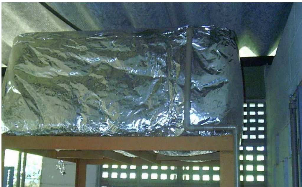
Figura 14. Reservatório de água quente utilizado inicialmente para o protótipo “B1”.
