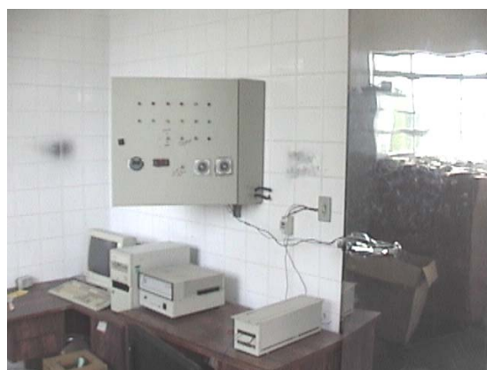
Figura 5. Vista do painel de controle da câmara climática.
