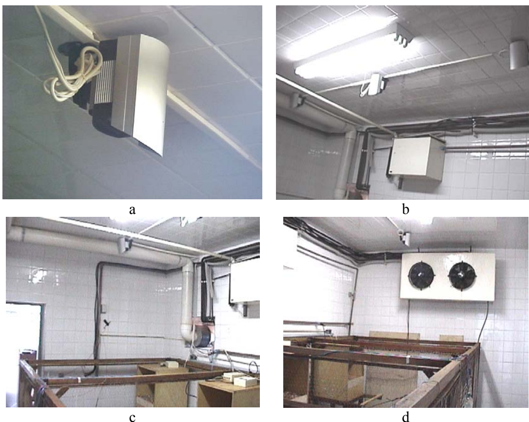
Figura 9. Detalhe das câmeras de vídeo instaladas no teto da câmara climática, sobre os boxes.
