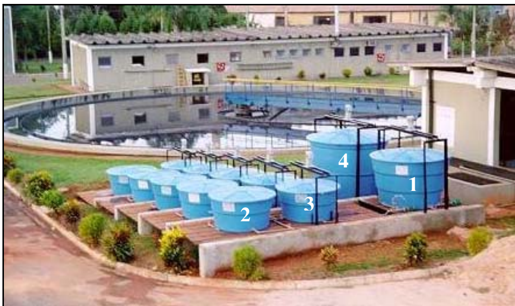
Figura 10. Vista geral das Instalações Experimentais: Caixa de Equalização (1), Sistema A (2), Sistema B (3) e Sistema C (4).
