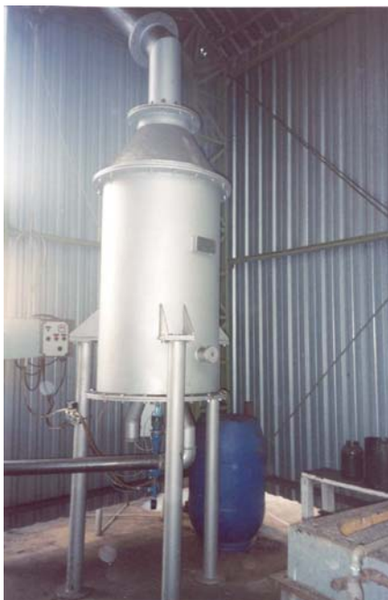
FIGURA 4.18 CÂMARA DE COMBUSTÃO DOS GASES DA PIRÓLISE
