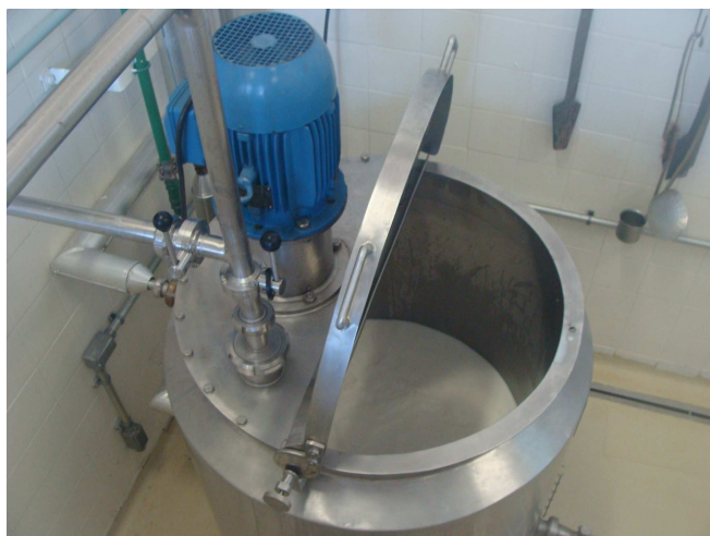
Figura 3. Tanque de pré-aquecimento do leite antes do tratamento térmico UHT (Planta Piloto Tetra Pak/ITAL).
