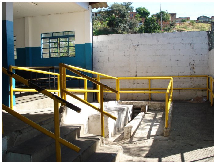
Foto da rampa sem a cobertura e a parte aberta do refeitório.
