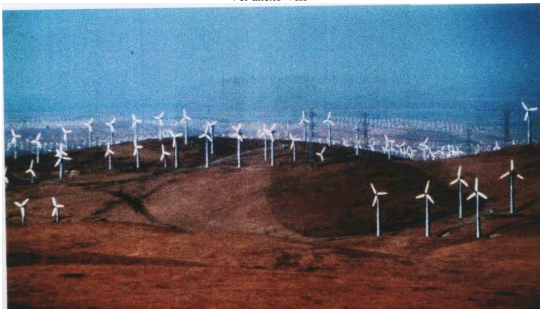
Figura 2.20 – Fazenda eólica para geração de eletricidade em grande porte
