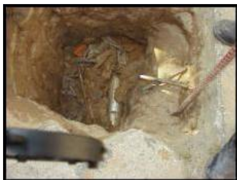
Figura 4.29: Pedacos de tubulação
