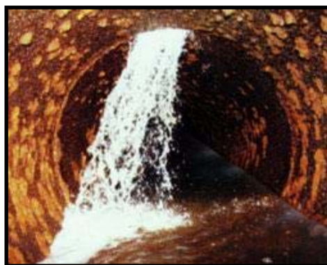
Figura 4.39: Tubulação com presença de tubérculos
