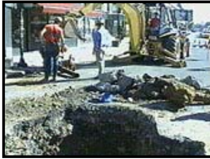
Figura 4.9: Poço de acesso
