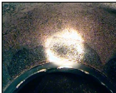
Figura 3.2: Presença de “pittings” dentro da carcaça da válvula
