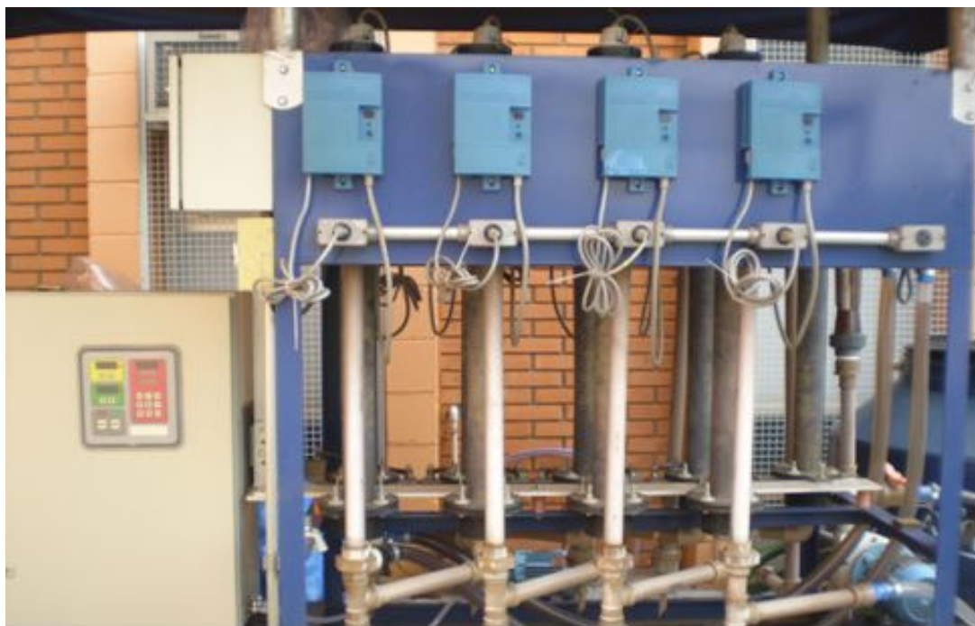
Figura 3.2: Unidade de tratamento
