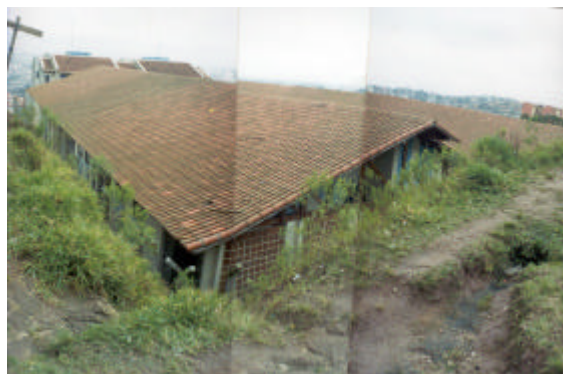
Foto 3.1: situação onde os recuos não foram aplicados. A)
