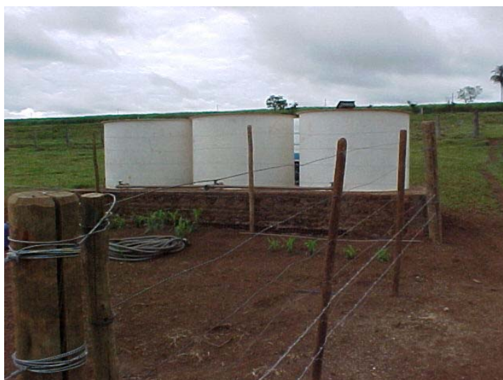
Figura 4.5-3– Tanque de armazenamento dos efluentes instalados no campo experimental na Fazenda Marfim, Rifaina-SP
