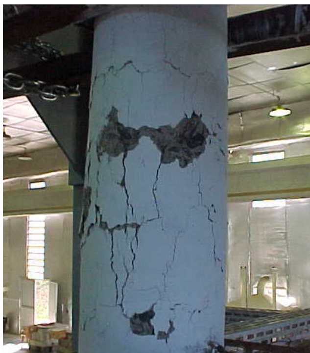
Figura 5.2 – Ruptura do pilar PCT
