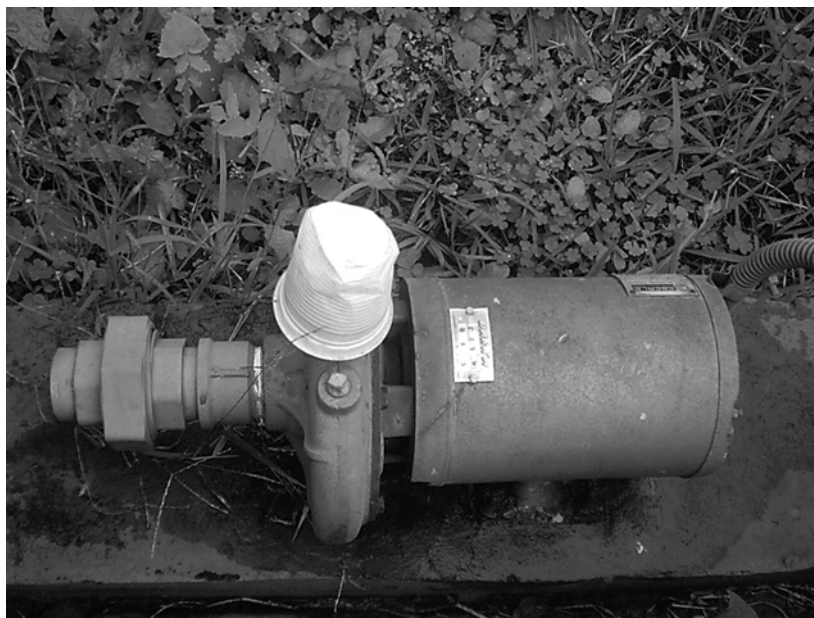
Figura 8 – Bomba de Irrigação – Estrutura A
