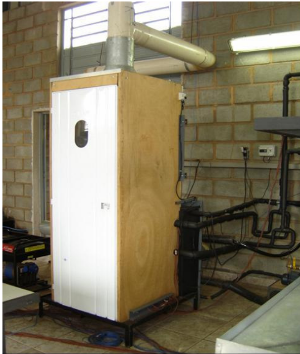
Figura 6.10: Secador de bandejas do sistema de bomba de calor em cascata.
