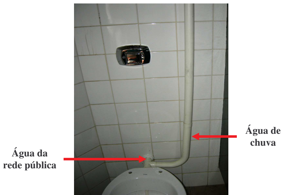
Figura 10. Vaso sanitário adaptado para descarga com água de chuva.
