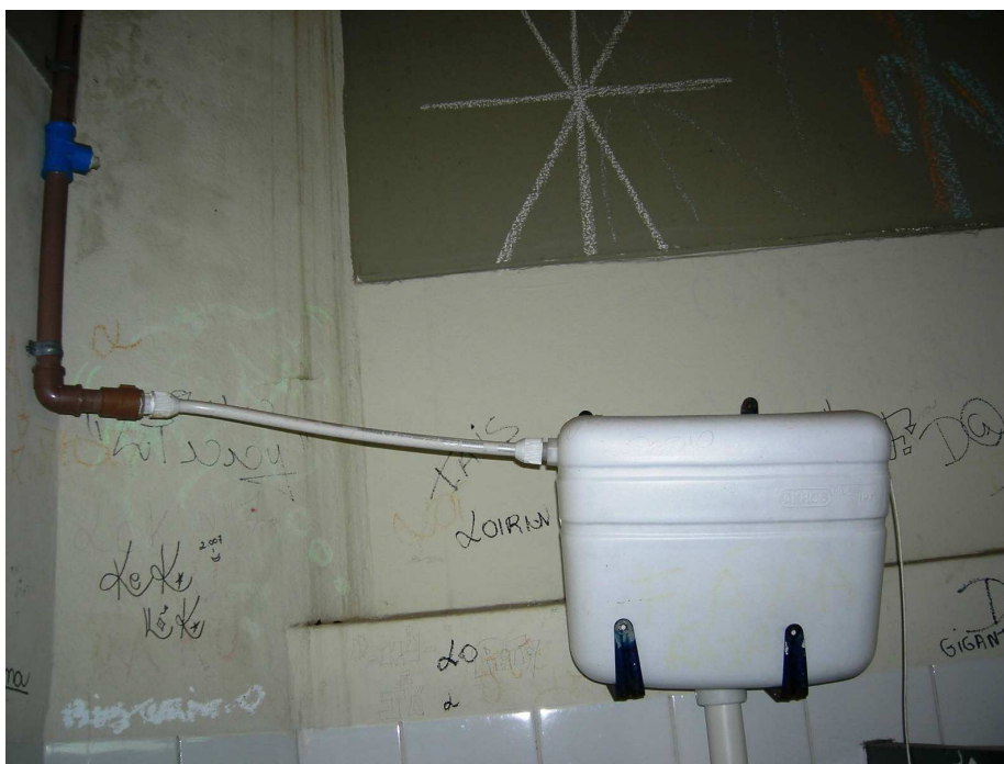
Figura 9. Caixa abastecida pela água de chuva.
