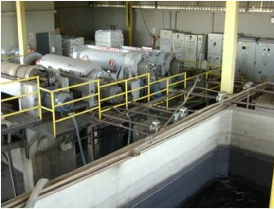
FIGURA 4.11: Galpão de desidratação do lodo.
