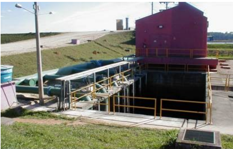
FIGURA 4.6: Estação elevatória de esgoto e ao fundo, em vermelho a subestação elétrica exclusiva da elevatória.
