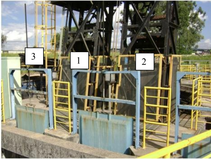
FIGURA 4.5: Gradeamento fino. Pontos: (1) grade mecanizada 01; (2) grade mecanizada 02; (3) correia transportadora dos resíduos para a caçamba.
