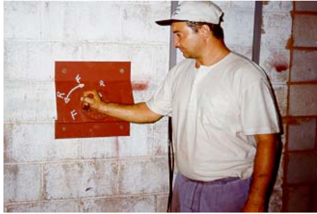
Figura 33: Painel controlador de velocidade
