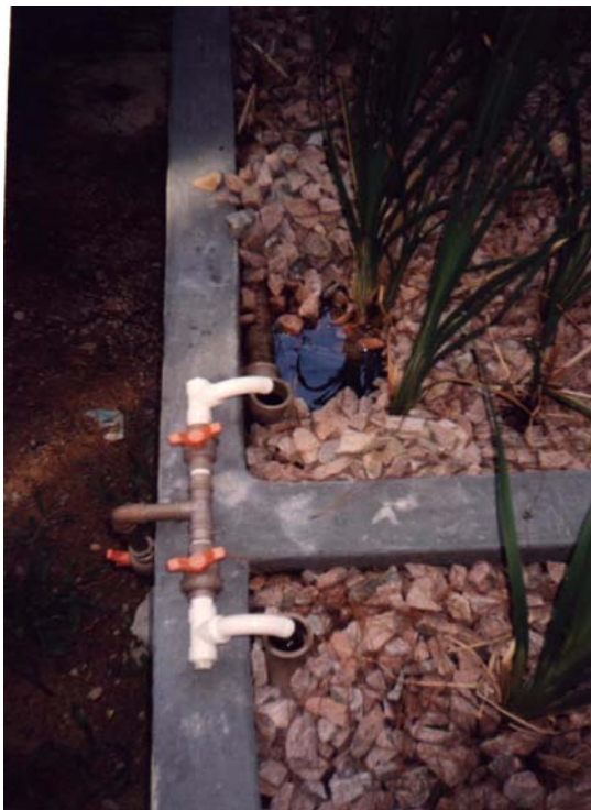
Figura 8. Detalhe da distribuição do efluente nos leitos.
