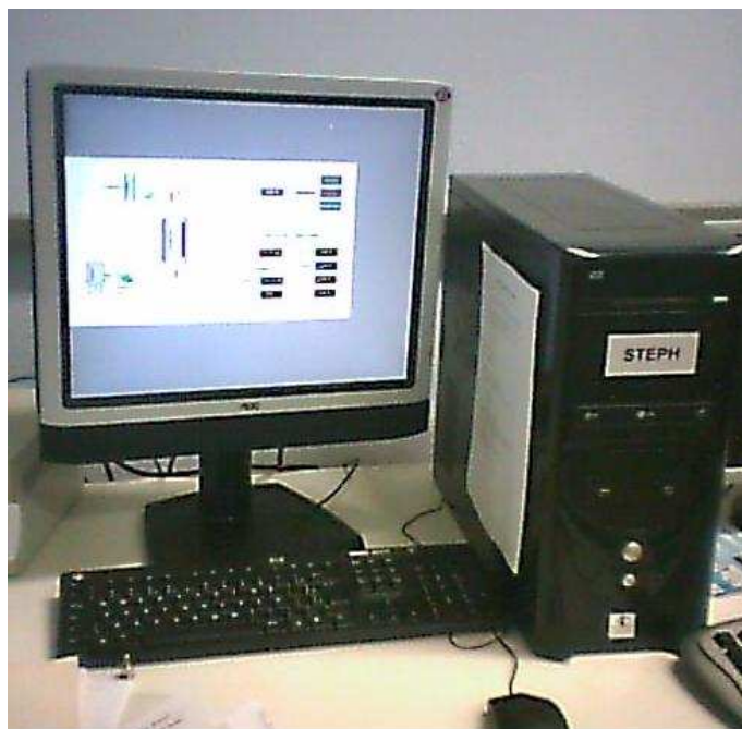
Figura 22. Servidor SCADA I e II
