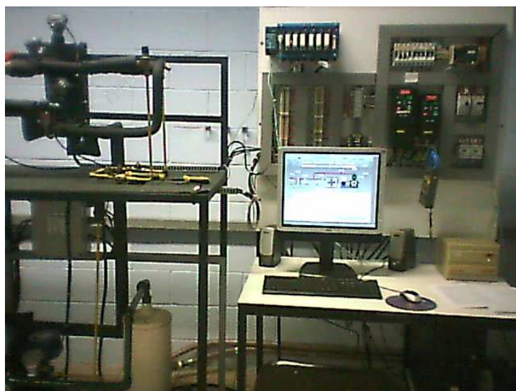
Figura 06. CLP na Planta de Refrigeração
