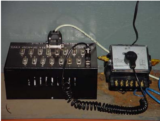
Figura 32 - Multiplexador Instalado no Edifício Piloto
