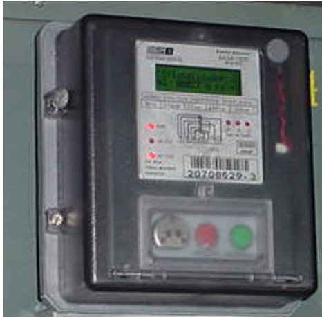
Figura 30 - Medidor Eletrônico de Energia.
