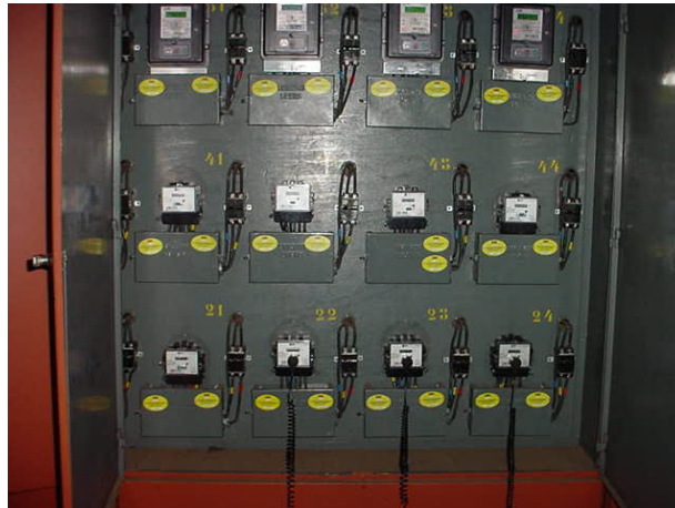
Figura 31 - Medidores Eletrônicos Instalados no Edifício Piloto.
