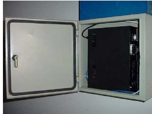
Figura 33 - Ponto de Presença Instalado no Edifício Piloto.
