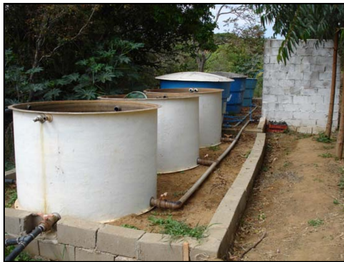
Figura 4.11 - Reservatórios de água e efluente implantados na pesquisa (Fonte: AUTOR, 2008)
