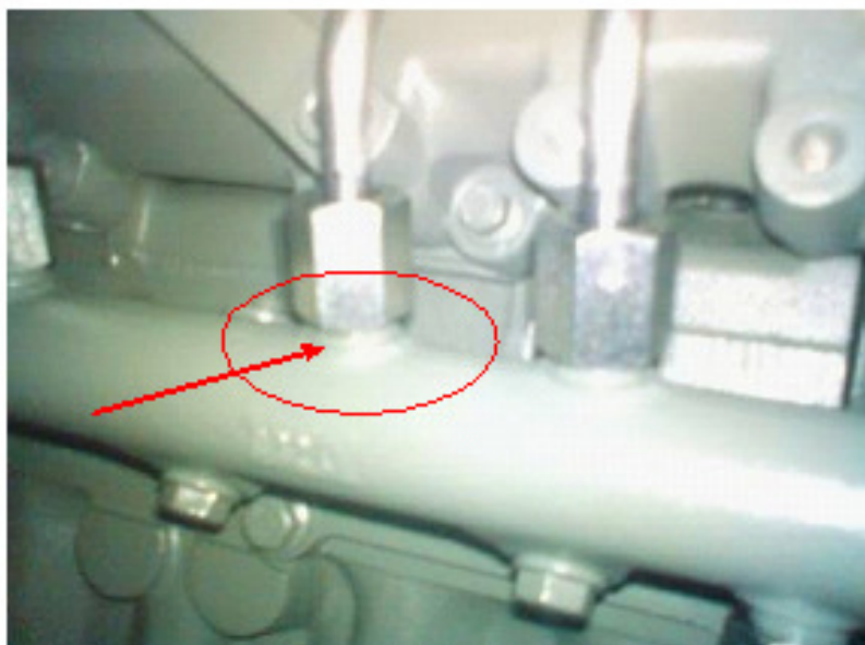
Figura 56 Presença de óleo diesel na conexão tubo e “rail”.
