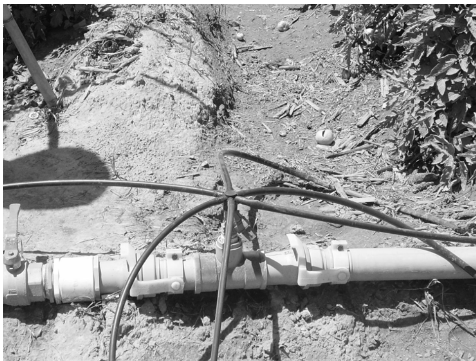
Figura 5. Regulador de pressão com conexão de múltiplas saídas.
