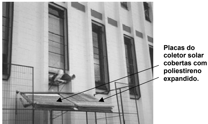
Figura 42. Vista parcial das placas do coletor solar.
