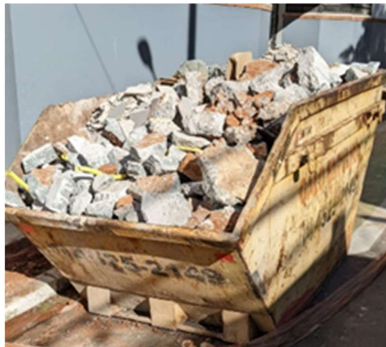
Figura 73- RCD selecionado na Obra
