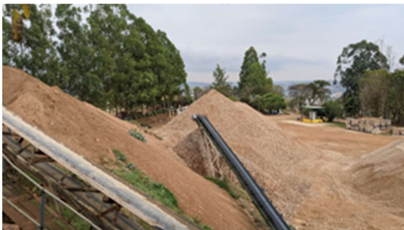
Figura 62- Usina em operação com restrição de espaço
