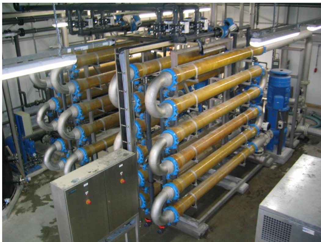
Figura 22. Sistema de lodos ativados com processo Cross Flow acoplado (Fonte: acervo do autor).
