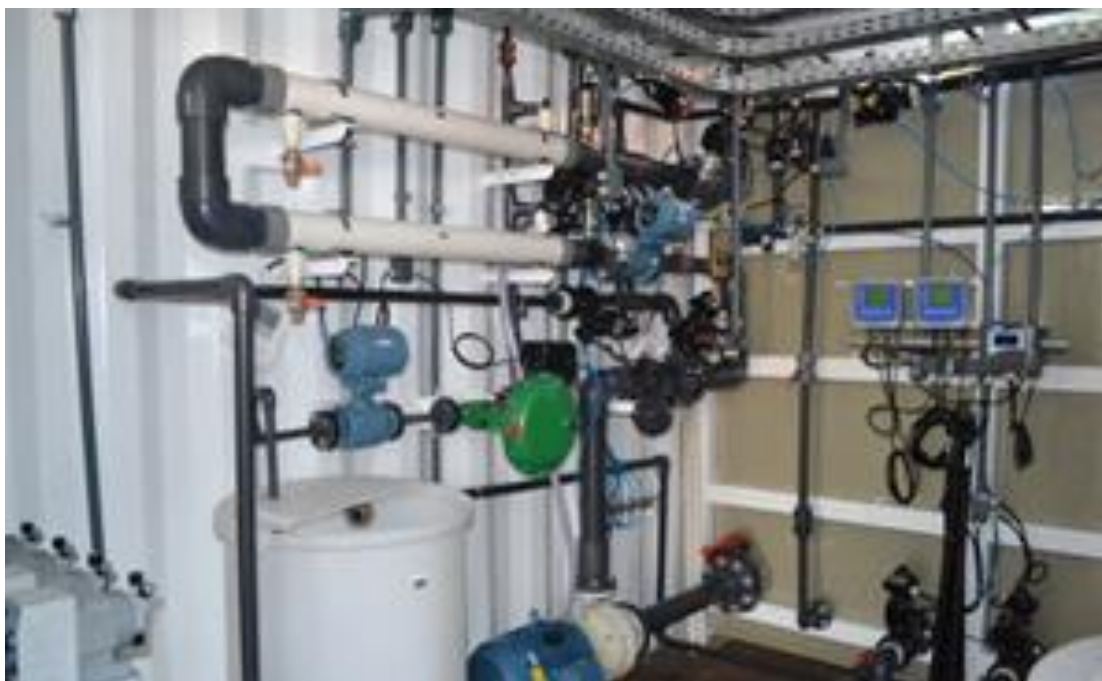
Figura 16. Sistema tanque de aeração com sistema Cross Flow (Fonte: acervo do autor).
